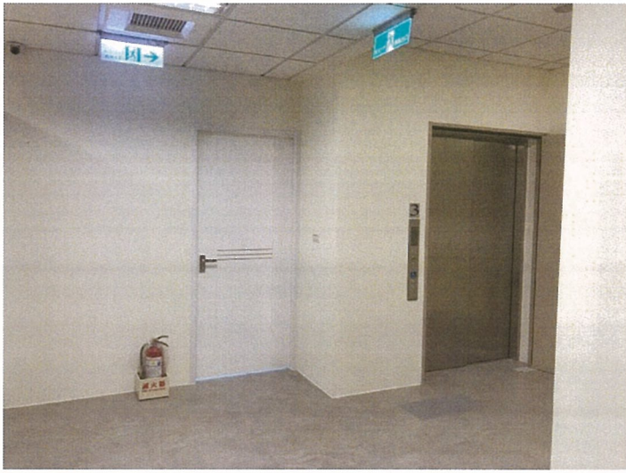
【消防及安全設備】
